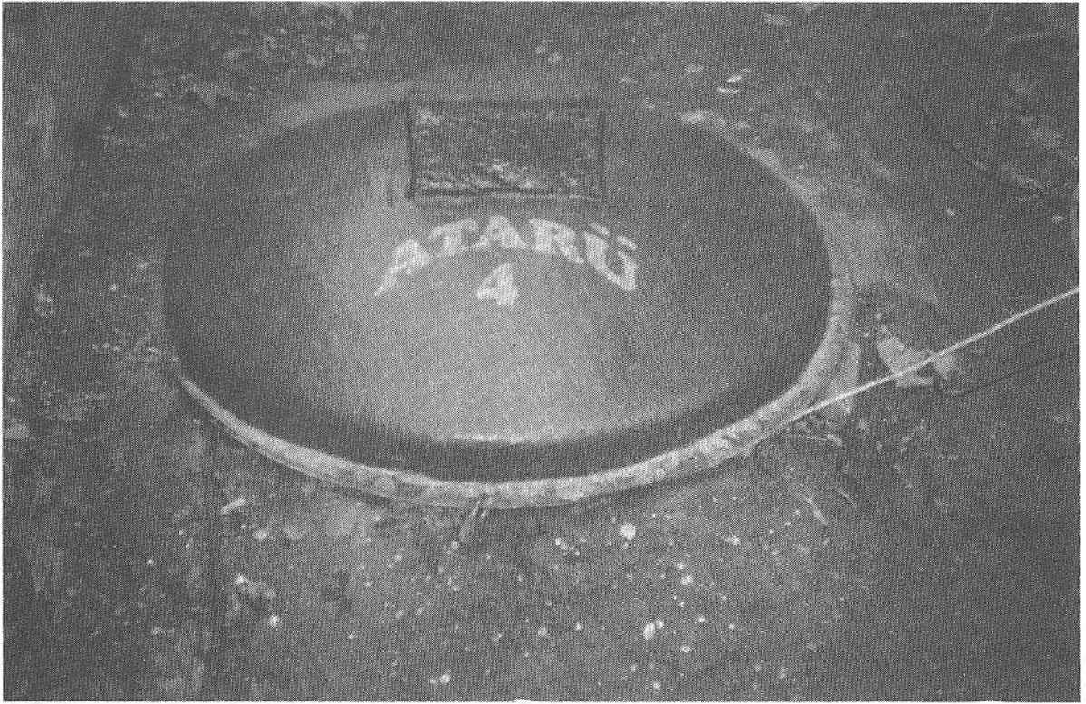
Şekil 1. Atıksu Arıtım Ünitesi (ATARÜ)
